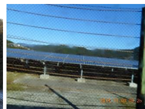
9:25 車窓/太陽光パネル
